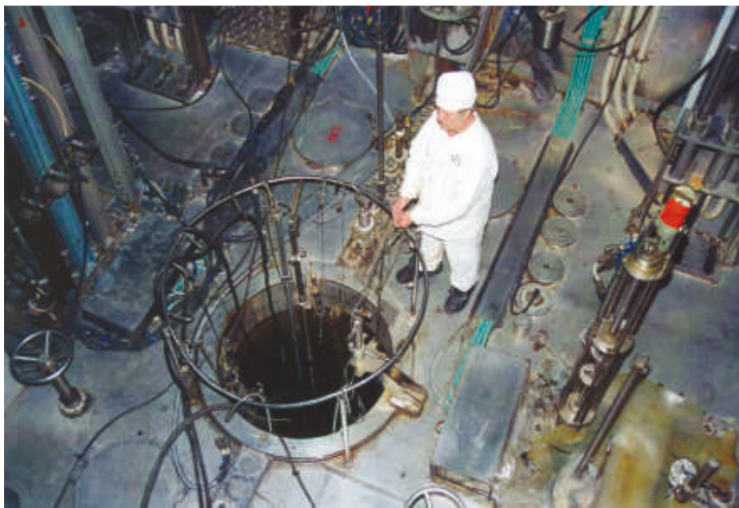
Зал реакторных установок РБТ-10/1 и РБТ-10/2
