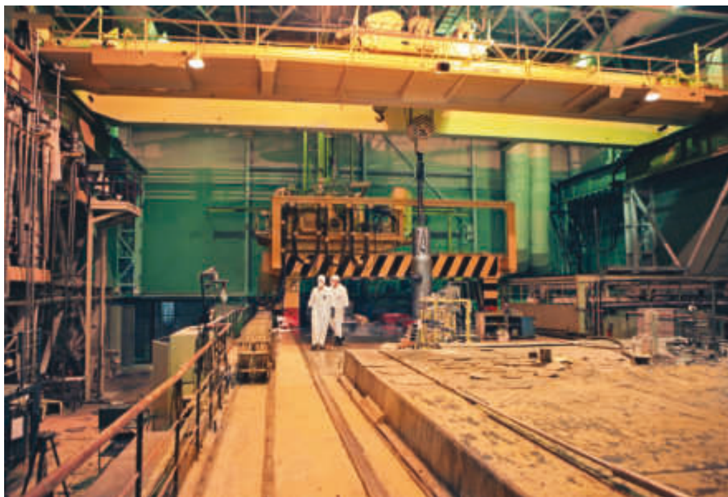
Центральный зал реакторной установки БОР-60
