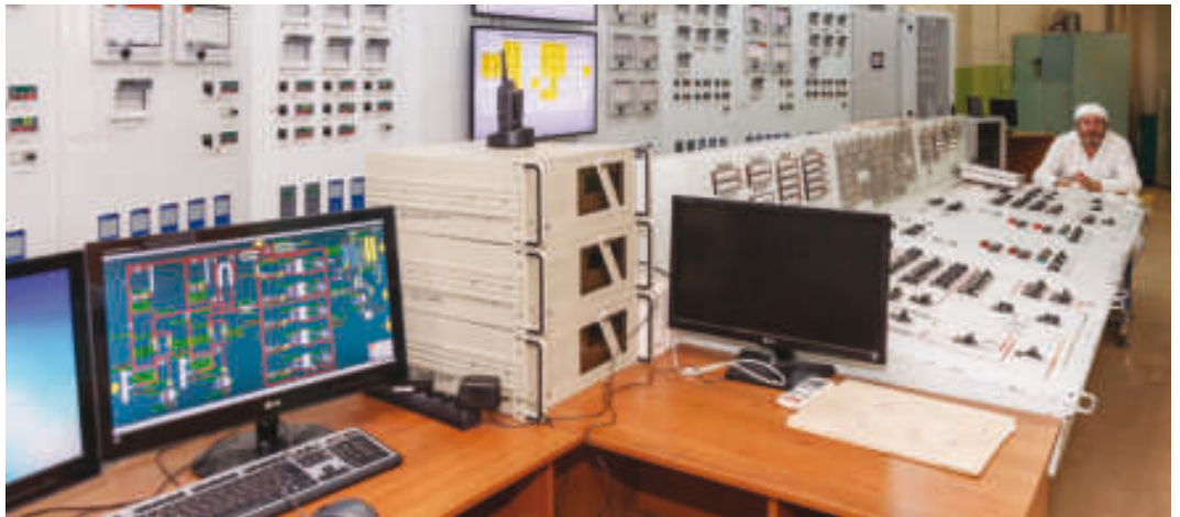
Пульт управления петлевыми установками реактора МИР
