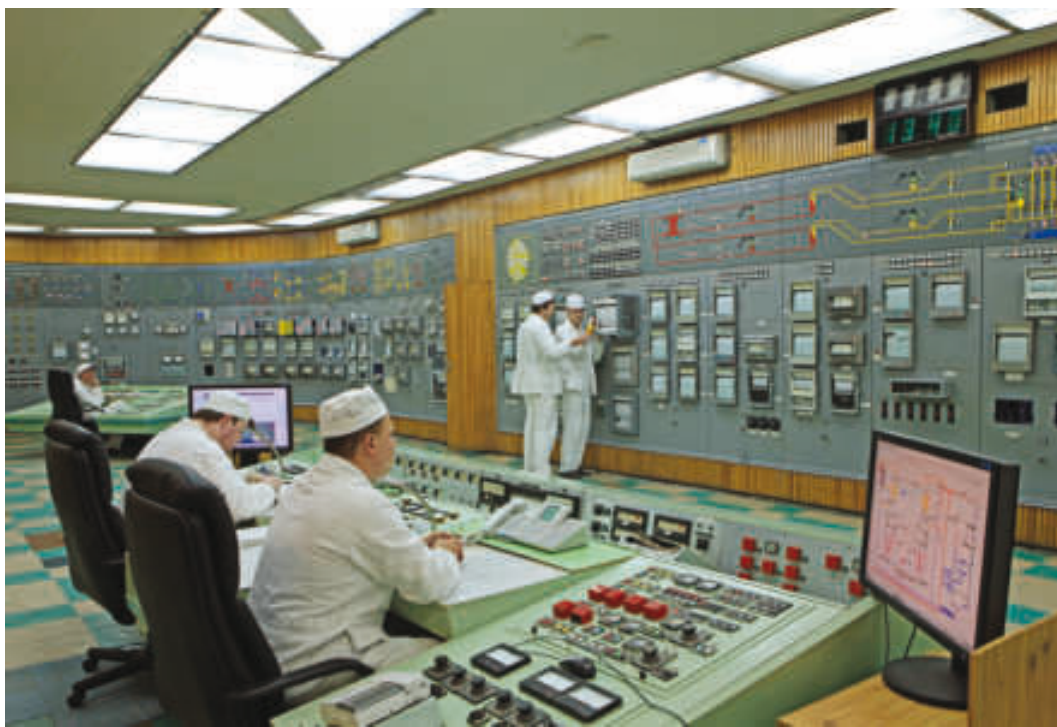
Пульт управления реакторной установки БОР-60
